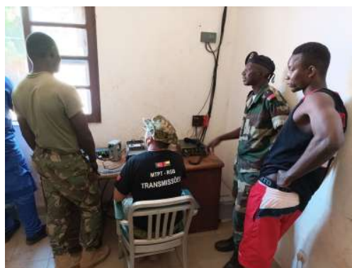
Figura 11 - Instalação do CTm de Bubaque
