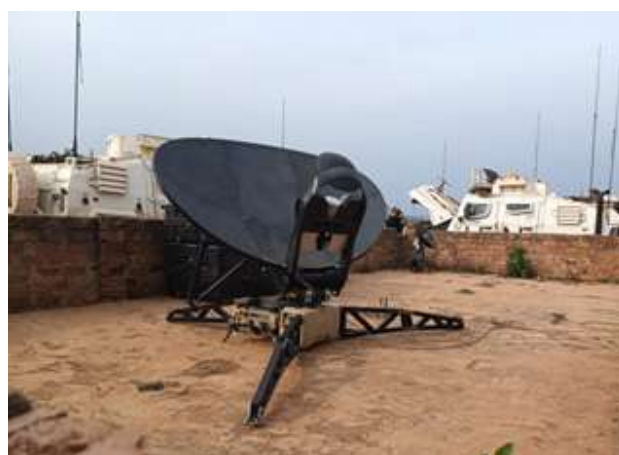
Figura 1 - Antena satélite DataPath CCT 200
